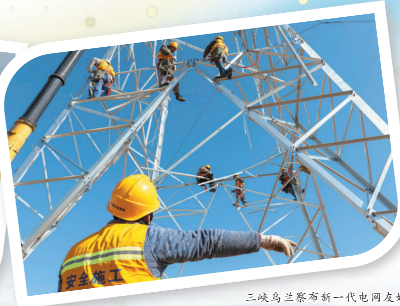
三峡乌兰察布新一代电网友好绿色电站示范项目(一期)并网工程。
