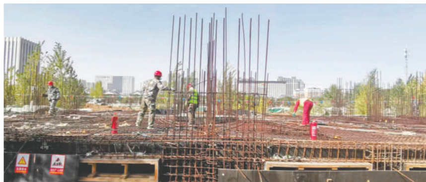
自治区本级东河二期项目改造工程施工现场。 本报记者 闫晨光 摄
