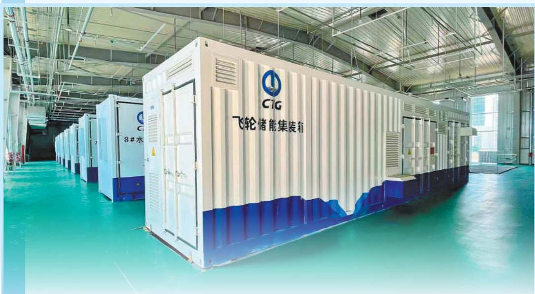
在乌兰察布市察哈尔高新技术开发区三峡现代能源创新示范园的“源网荷储”技术研发试验基地,一排排储能集装箱整齐放置。 本报记者 王磊 通讯员 李豹 摄
