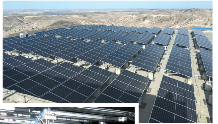
光伏发电项目为矿区提供清洁能源。
