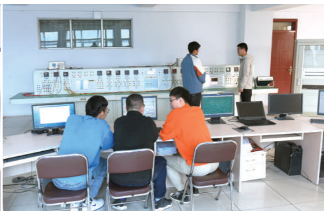
新能源电力系统动态模拟实验室集控室。
