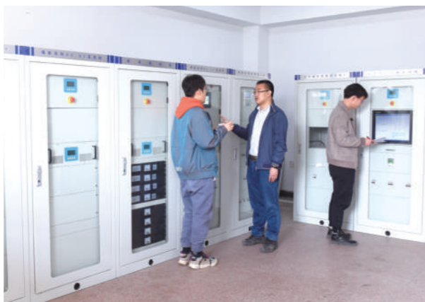
风光储直流微电网实验室。
