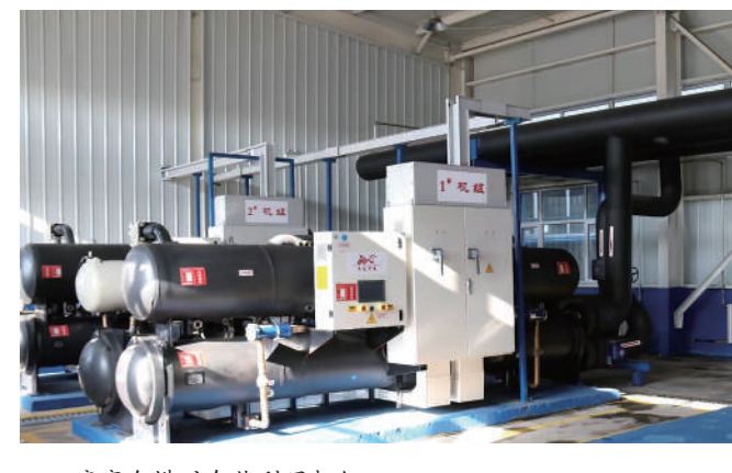
唐家会煤矿余热利用机组。
