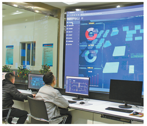
实时监控供暖运行情况。
