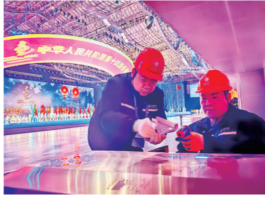
2月17日,国网蒙东电力保电人员在呼伦贝尔的“十四冬”开幕式主场馆进行电力设备巡视测温。 梁嘉贺 摄
