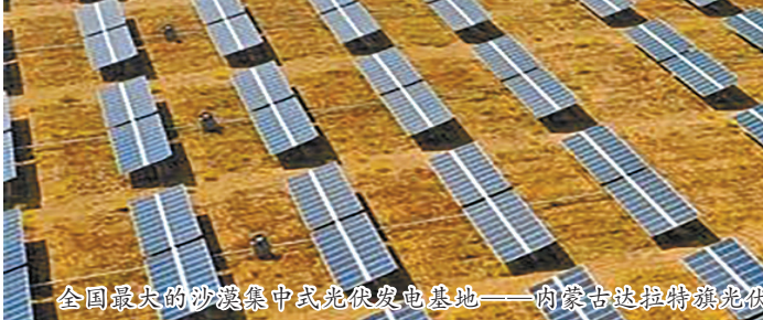
全国最大的沙漠集中式光伏发电基地——内蒙古达拉特旗光伏电站领跑基地。(新华社图片)
