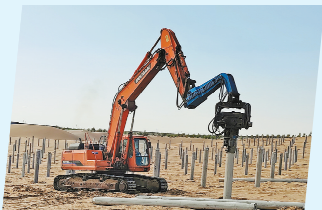
达拉特经济开发区增量配电网绿色供电项目作业现场,打桩机正在打桩。
