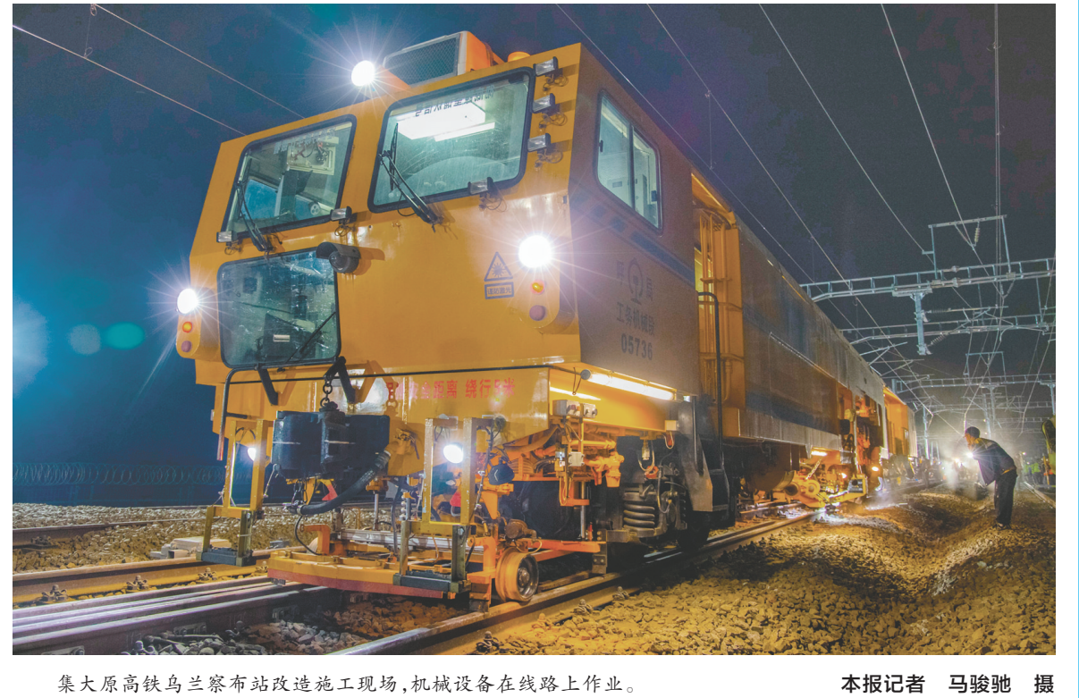
集大原高铁乌兰察布站改造施工现场,机械设备在轨道上作业。
