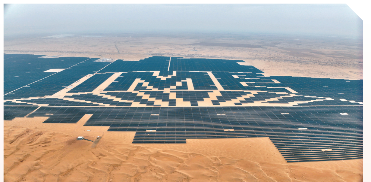
内蒙古能源巴彦淖尔100万千瓦光储+生态治理项目。
