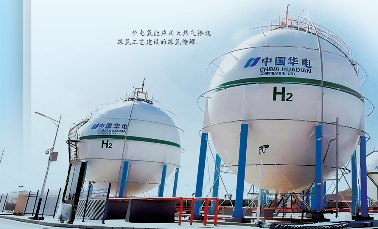
华电氢能应用天然气掺烧绿氢工艺建设的绿氢罐罐。
