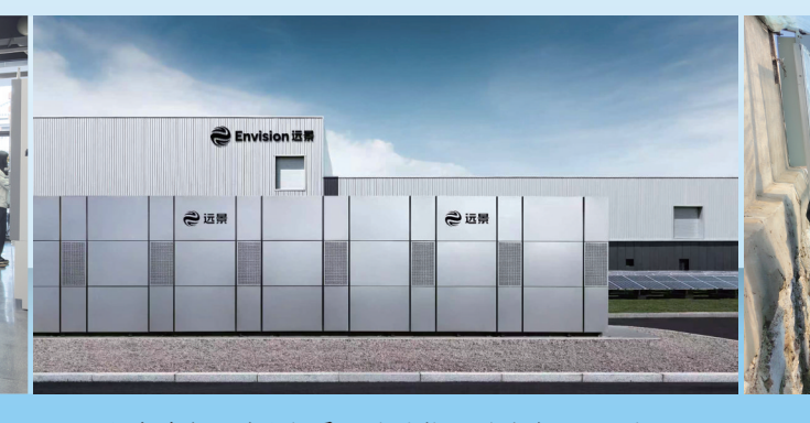
全球首个通过全场景测试的构网型储能项目现场。
