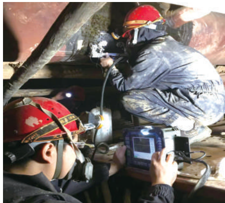
内蒙古自治区特种设备检验研究院在新能能源有限公司针对设备腐蚀严重点进行数据采集。
